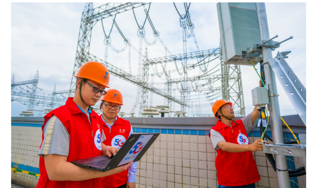
2019年6月20日，安徽省宣城市分公司技术人员在古泉换流站对5G基站进行测试
